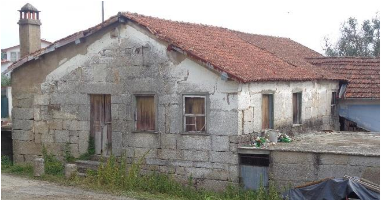
Imagens 19 a 22. Fotografias de construções degradadas / em ruínas.
